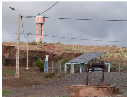
Pompage Solaire Ouled Ami Ahmed
